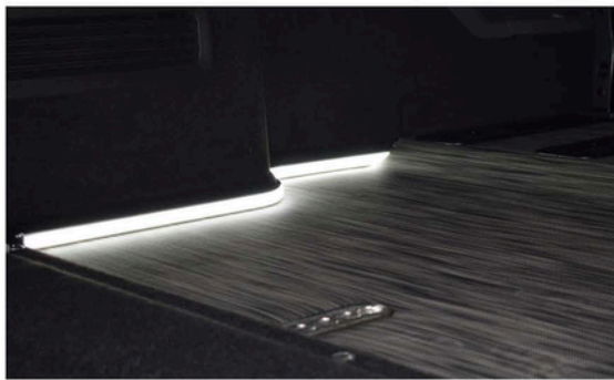
3- Iluminación LED. Integrada en la zona destinada al pasajero en silla de ruedas.
